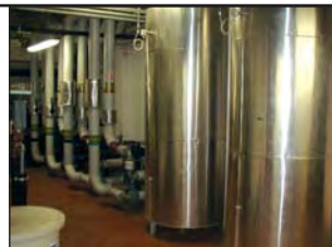
Stockage de l'eau chaude pour les sanitaires
